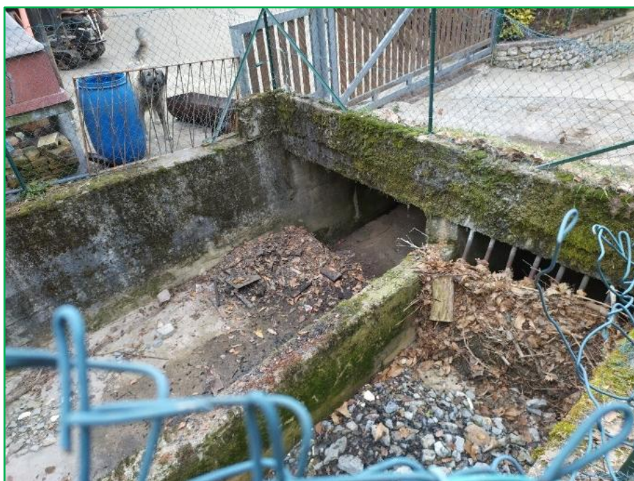
Figura 31 - Punto critico C_15: ingresso tombotto del Torrente Comel in Via Pascoli
