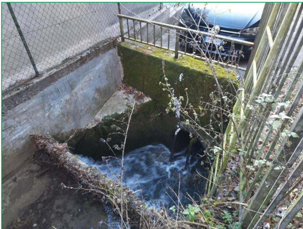
Figura 62 - Punto critico C_27: ingresso del tombotto in Via Valle Misma
