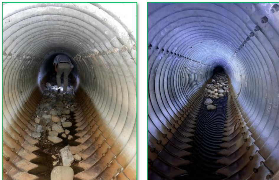
Figura 35 - Immagini della videoispezione del 2023 lungo la tubazione del Comel verso il Torrente Rovaro
