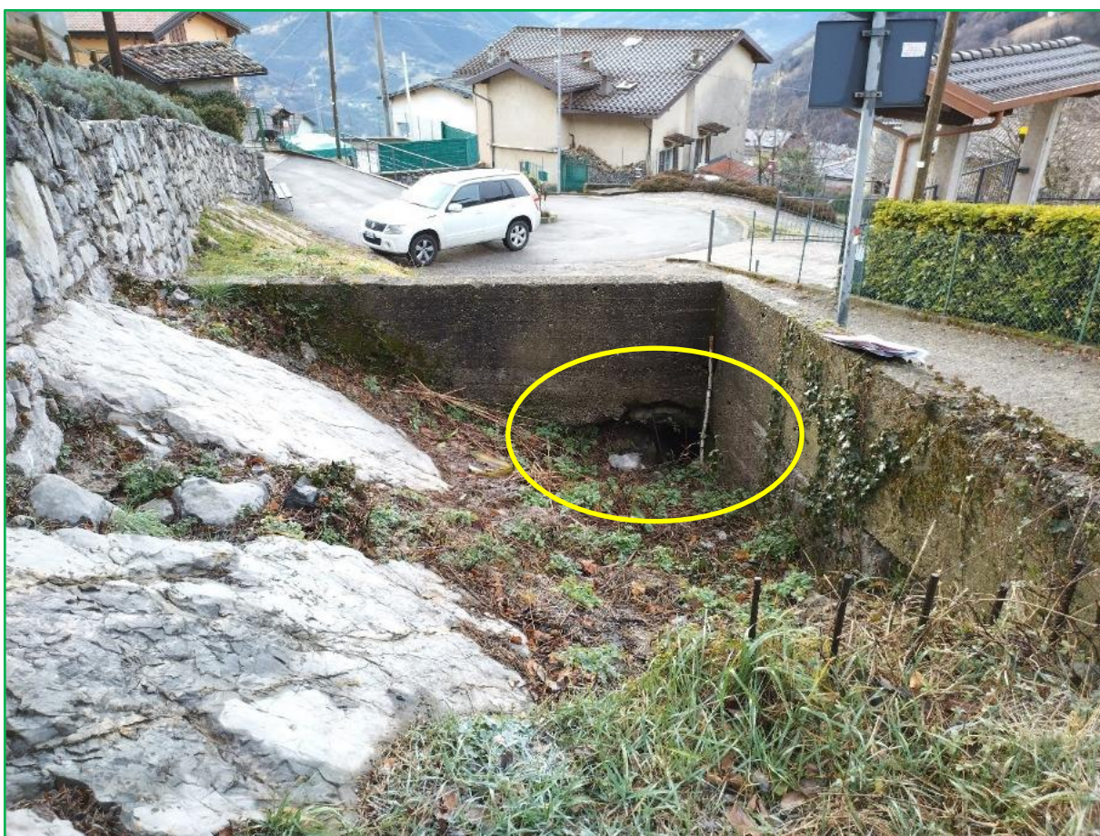
Figura 46 - Ingresso del tombotto alla sommità di Via Oschiolo (punto critico C_07)
