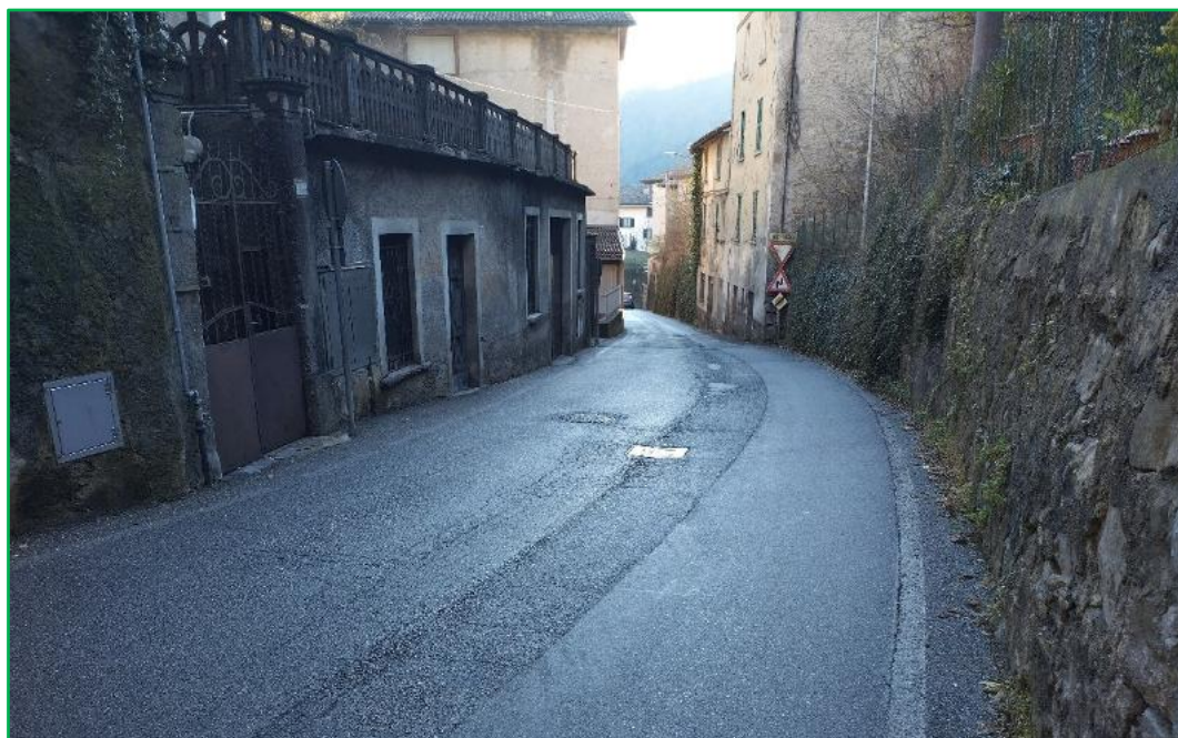
Figura 55 - Via Masserini (S.P. 41) appena a monte della Piazza 25 Aprile, con una configurazione in trincea facilmente allagabile
