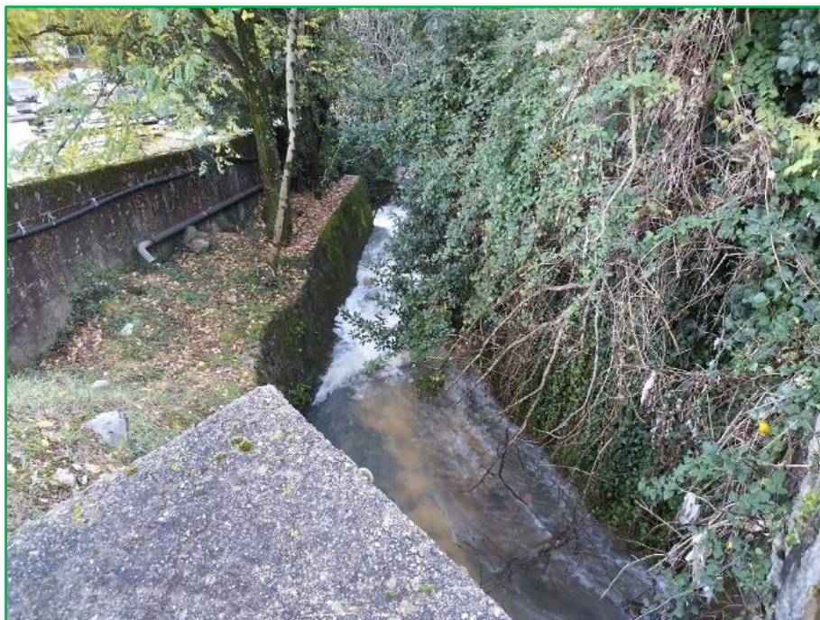
Figura 21 – Alveo artificializzato del Torrente Rovaro nella zona apicale della conoide, a valle di Via Gusmini (punto critico C_21 e tratto critico conseguente)
