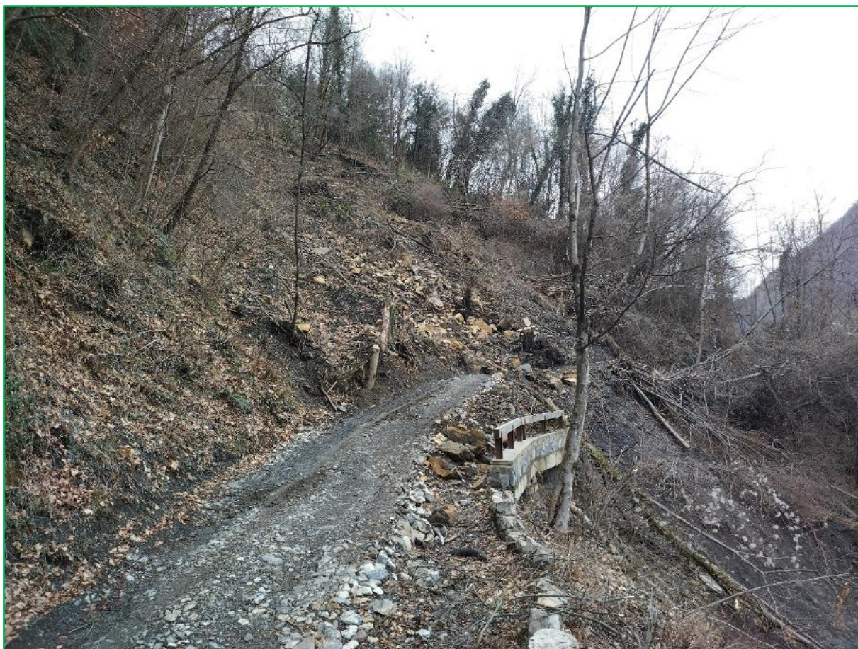
Figura 10 – Frana lungo la strada per la Val de Grù in località Clacchei, avvenuta nell'autunno 2023
