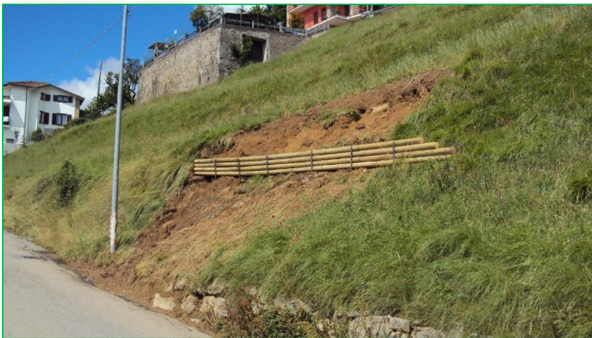
Figura 82 – Smottamento lungo Via Don Bossetti del giugno 2016
