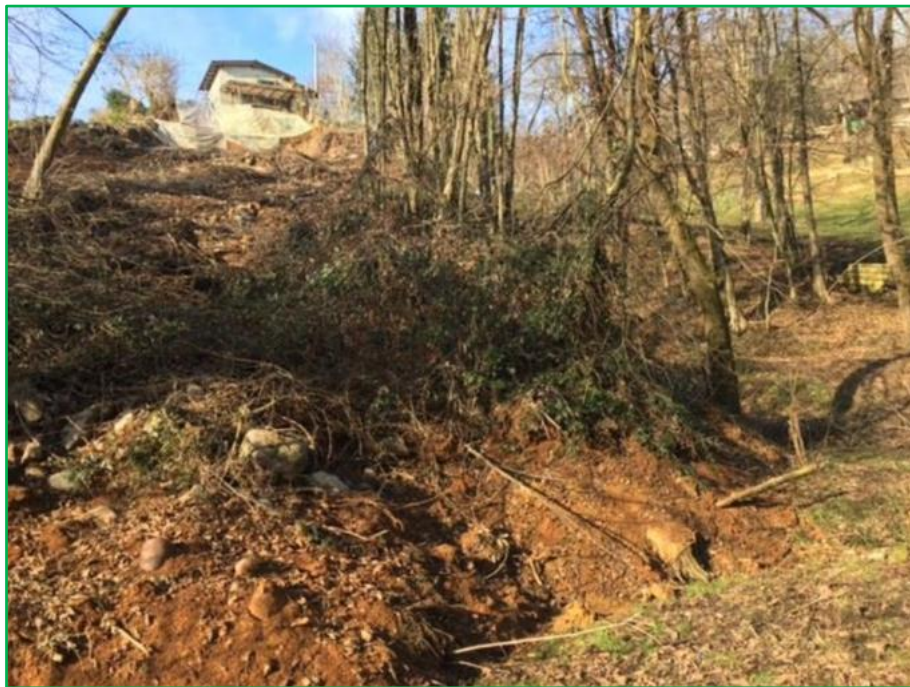
Figura 72 – Immagini della frana di Via San Rocco del 27 ottobre 2020 (dalla relazione del Geom. Walter Campana)
