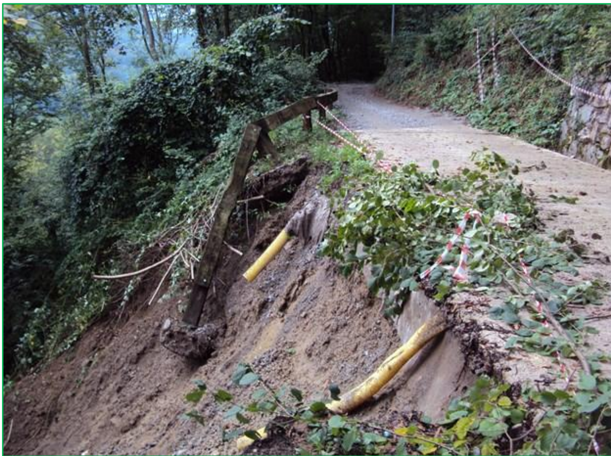
Figura 87 – Frana lungo la strada per la Val de Grü in località Piazzoli nel settembre 2010
