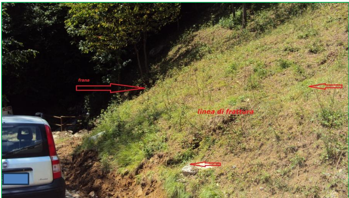
Figura 78 – Zona della frana di Orezza (documentazione da Comune)
