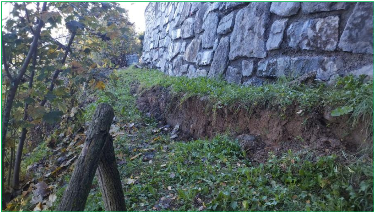
Figura 76 – Frana al tornante di Via Bossetti dell'ottobre 2024
