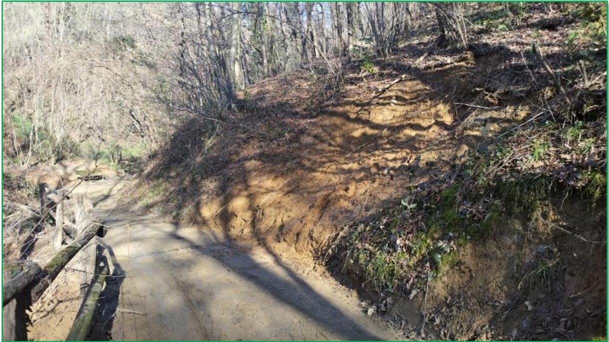
Figura 96 – La frana più piccola lungo la strada per Mozzo
