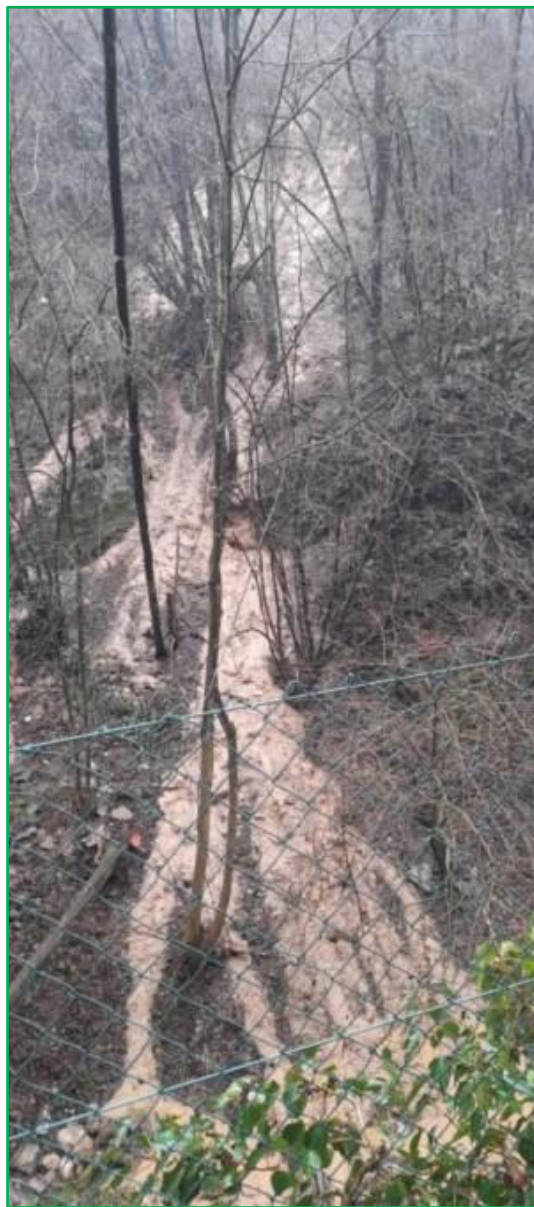
Figura 69 - Smottamento superficiale lungo la Valle San Carlo, in sponda idrografica destra, del gennaio 2021
